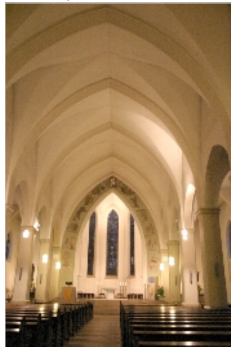
Die Wandfarbe des ehemals weißen Kirchenschiffes ist grau von Stockflecken, Staub und abgewetztem Anstrich
